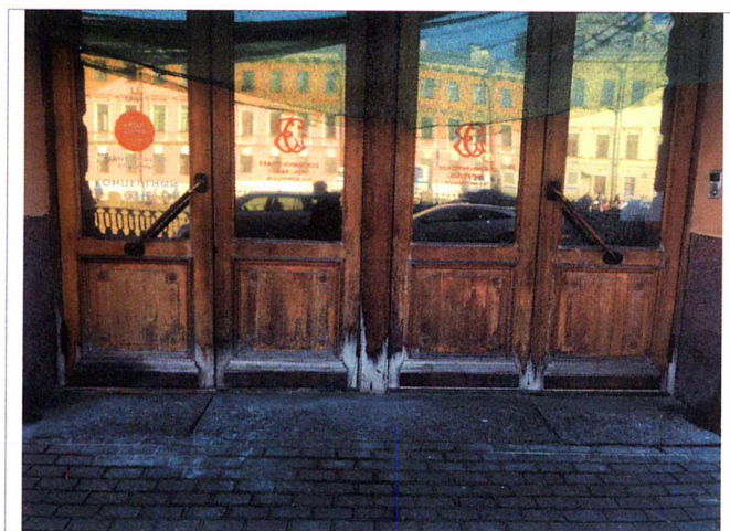
Фото №5 – Внешняя входная дверь.
