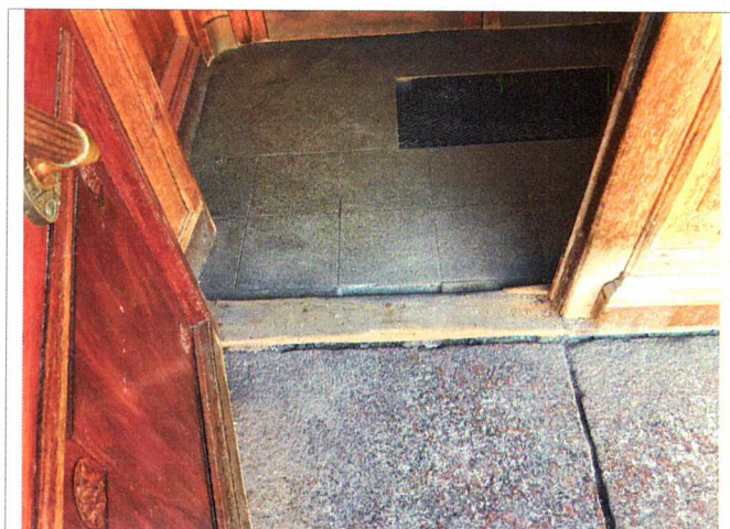
Фото №6 – Внешняя входная дверь.
